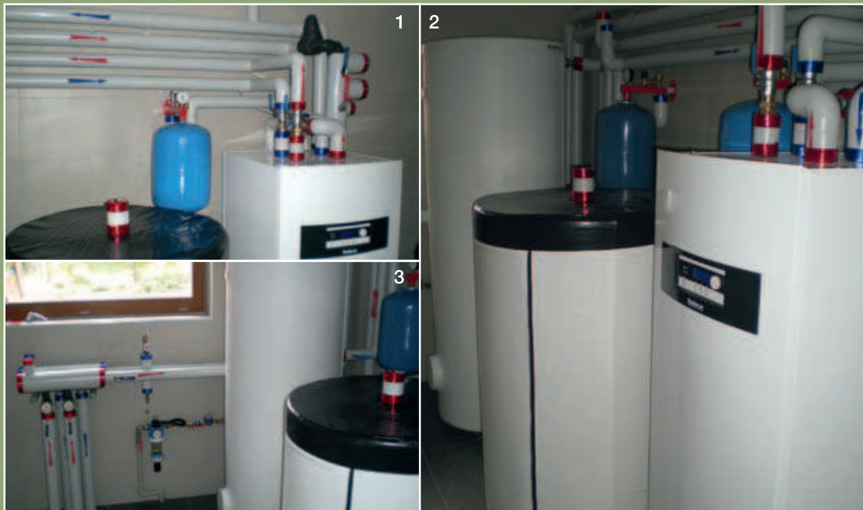
1 – widok ogólny rurociągów podłączonych do pompy ciepła 2 – ogólny widok węzła ciepłego: pompa ciepła Buderus Logatherm, bufor i podgrzewacz c.w.u. 3 – widok rozdzielacza dolnego źródła ciepła
